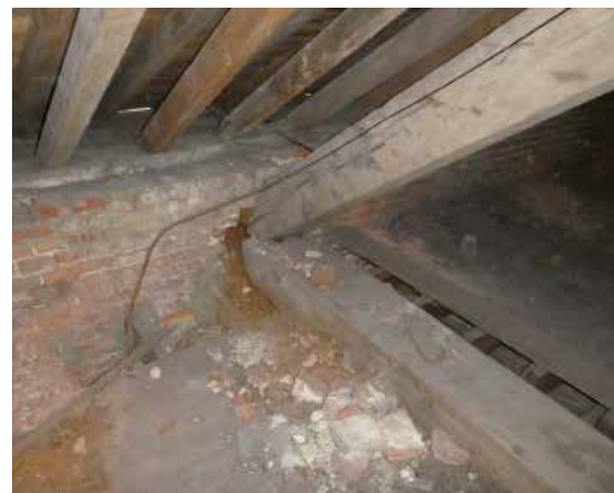
About de sommier totalement érodé et consumé par la pourriture cubique.
