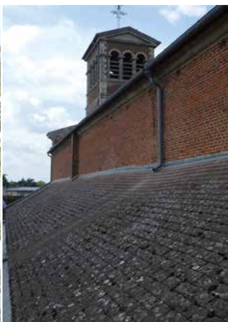
Le versant Sud est également colonisé par les lichens et les mousses, les rives en tête de versant sont fortement déformées.
